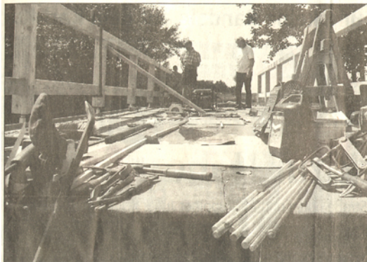
Eine der drei Brücken über den Königsgrieben, die die beiden Plätze verbinden sollen, erhielt gestern Nachmittag ihr neues Geländer. Fotos (3): Kluge
